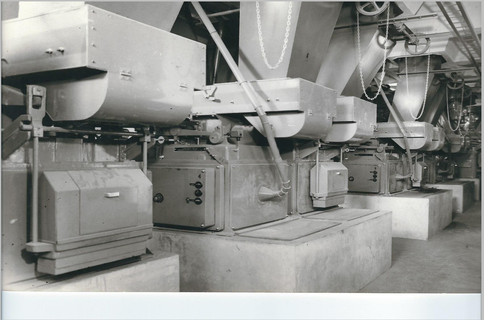
Ensimmäisen kerroksen annosteluvaa'at.
